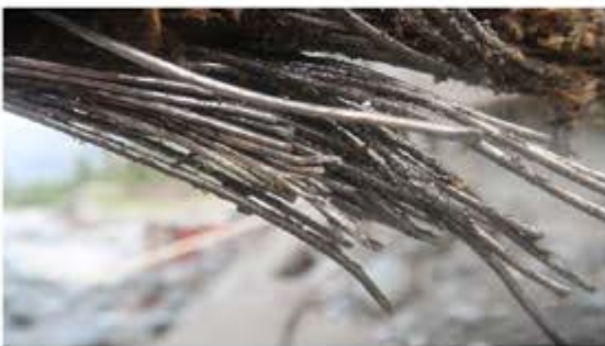
图 4 3#索塔南侧主缆断裂照片
